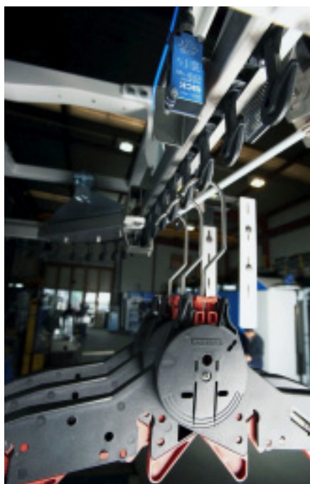
Kleiderbügelerkennung im Auslauf der Faltmaschine.
