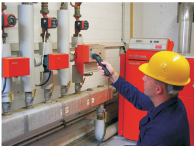
Überprüfen der Temperatur an Heizkreisen
