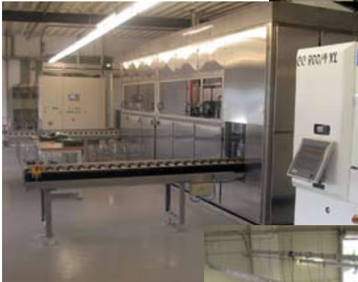
Beschichtungszentrum Coating center Centre d'application des revêtements Centro impianto rivestimento
