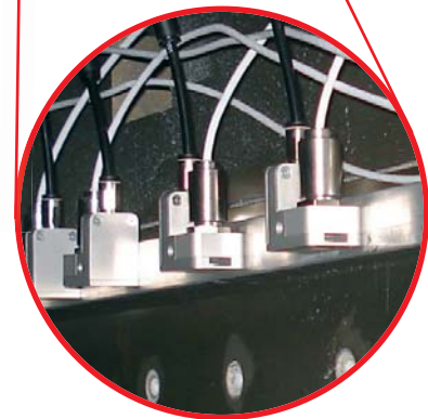
In einer Maschine installierte, kleine optris CT LT - Messköpfe mit Laminar-Freiblaseinrichtung
